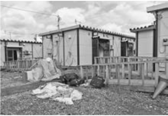
水害にあった仮設住宅
